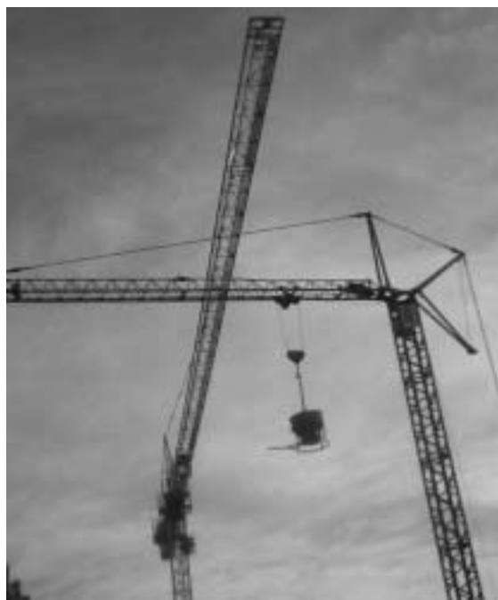
▲ Gru interferenti - I bracci non collidono tra loro (quello più alto passa sopra la struttura dell'altra gru) ma i carichi potrebbero urtare tra loro. Si applica la procedura relativa alla c.m. n° 22856
